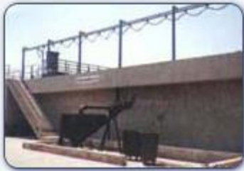
รางดักกรวดทราย (Grit Chamber)
