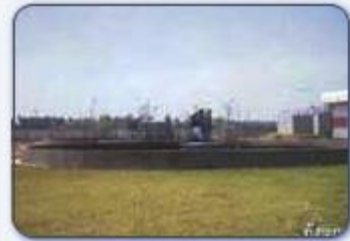
ถังตกตะกอน (Sedimentation Tank)
